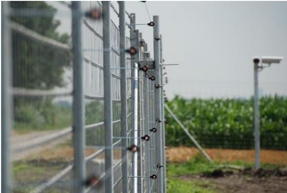
Fot. 3 Przykładowe ogrodzenie farmy fotowoltaicznej
