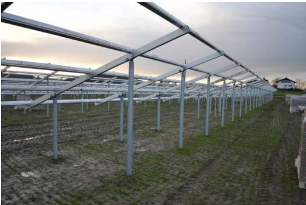
Fotografia nr 3. Instalacja fotowoltaiczna wykonana w technologii opisywanej w niniejszym raporcie.
