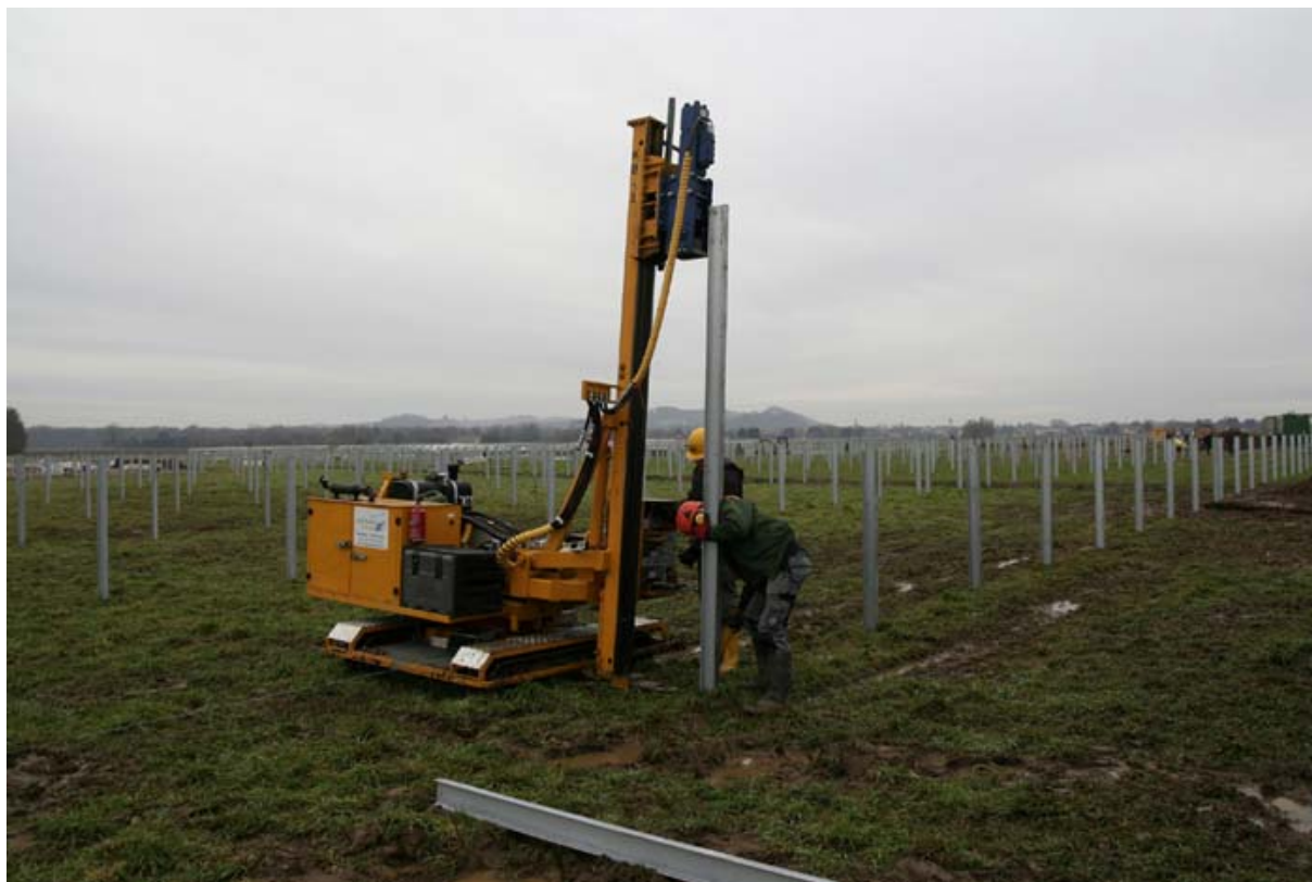
Fotografia nr 2. Instalacja fotowoltaiczna wykonana w technologii opisywanej w niniejszym raporcie.
