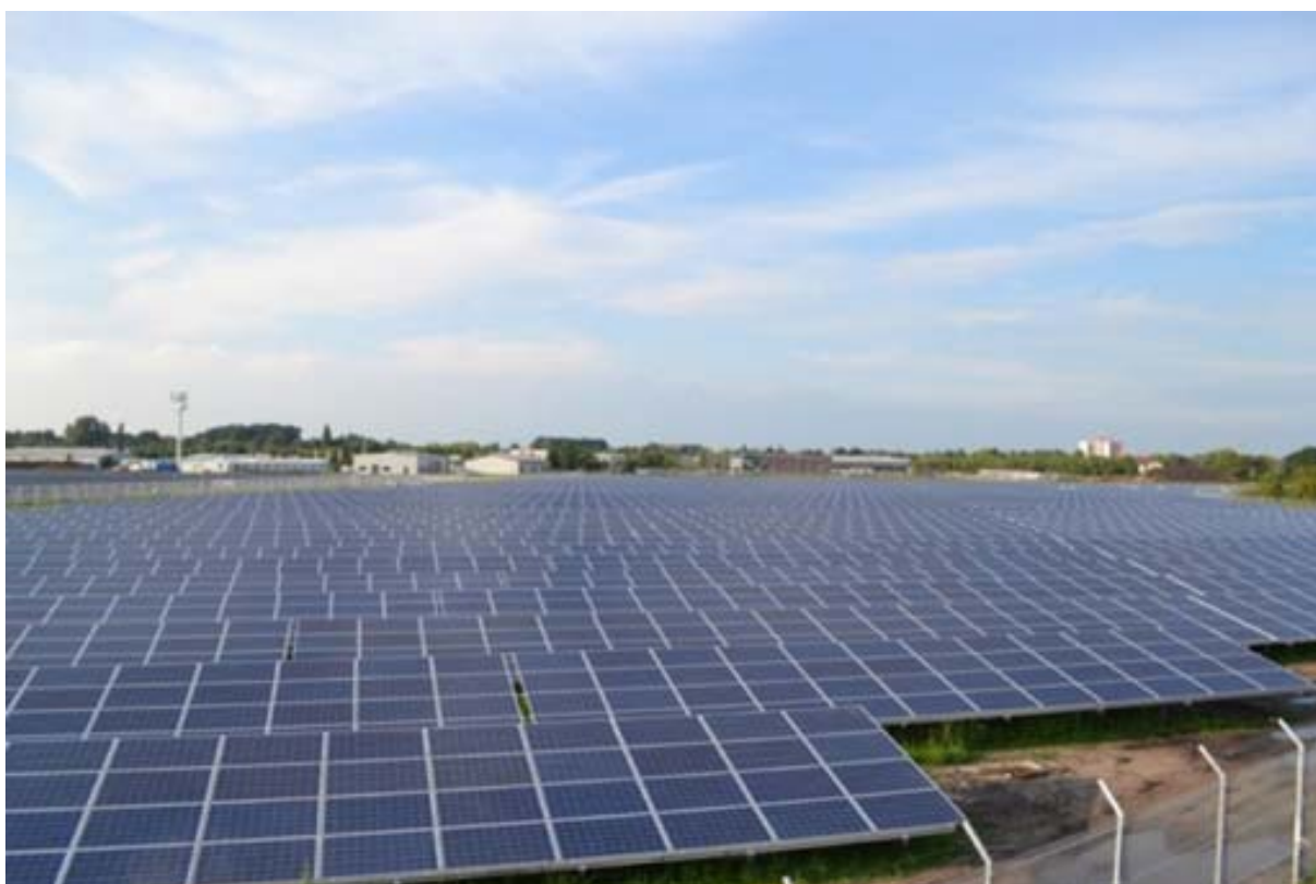
Fotografia nr 4. Instalacja fotowoltaiczna wykonana w technologii opisywanej w niniejszym raporcie.
